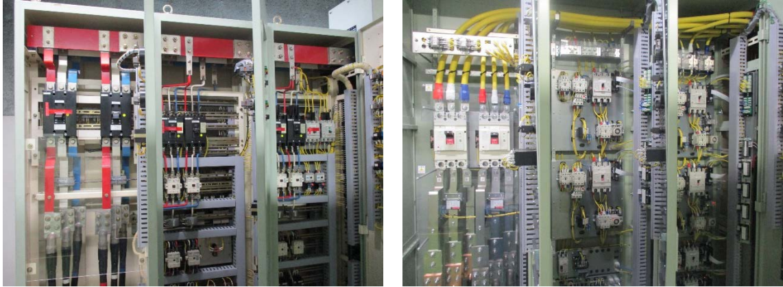
写真 2.1.7-2 空調設備動力制御盤No.1～No.3 (左)旧、(右)新
