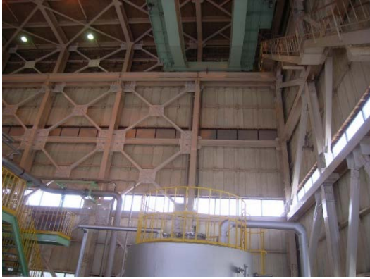
写真 2.10.1-1 大型再冠水実験棟 鉄骨ブレース改修 改修前
