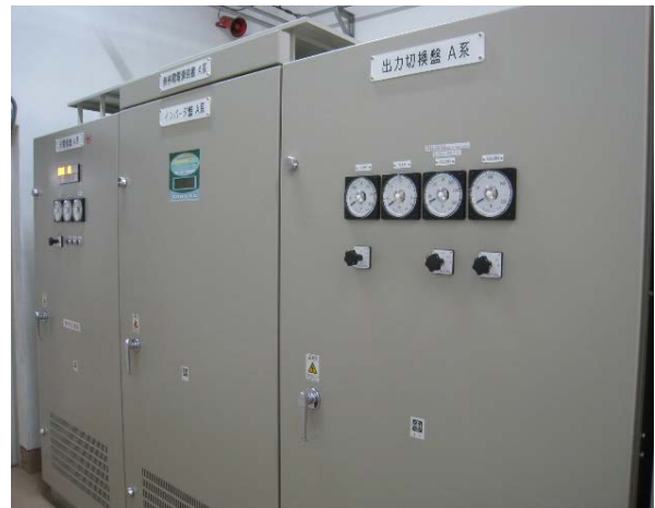
写真 2.10.3-2 無停電電源装置更新後
