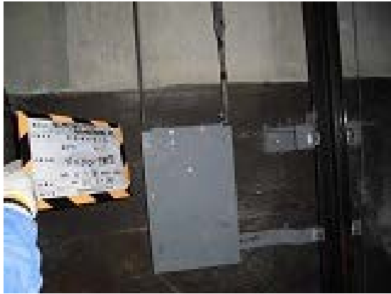
写真 2.10.2-3 減容処理棟 昇降機（荷物用）調速機用ロープ 更新後
