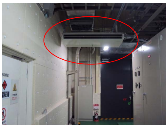
電気室内北側
