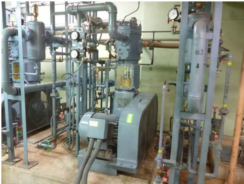
写真 2.1.6 燃料試験施設空気圧縮機
