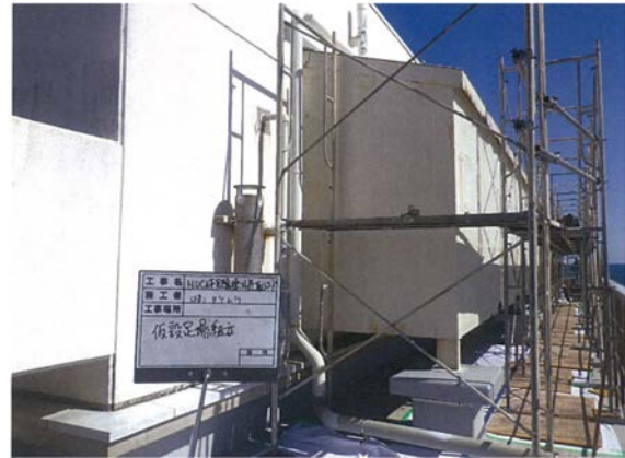
写真 2.1.5-2 外気取入フード 更新前（西側）
