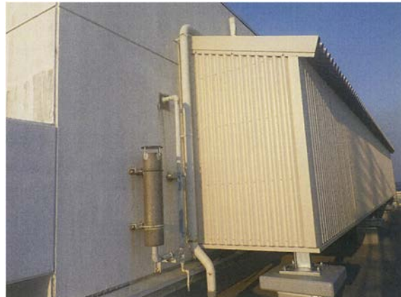
写真 2.1.5-4 外気取入フード 更新後（西側）
