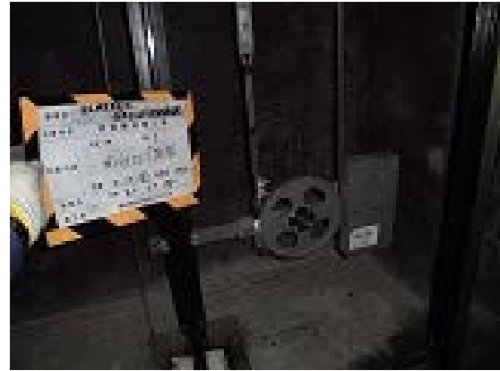
写真 2.10.2-4 減容処理棟 昇降機（乗用）調速機用ロープ 更新後
