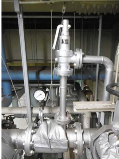
写真 2.1.12-1 第4研究棟西棟安全弁の更新後
