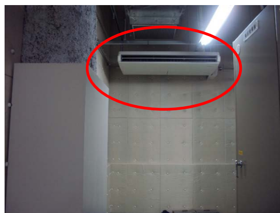
電気室内南側
