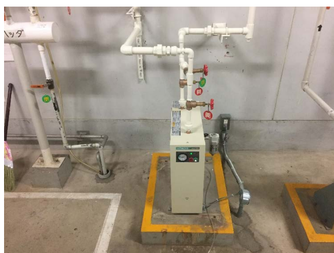
写真 2.1.9-3 更新後の除湿機
