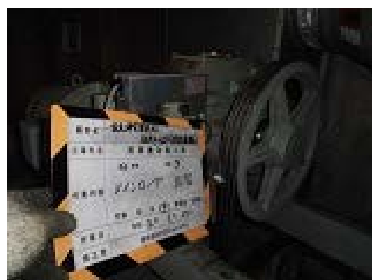
写真 2.10.2-2 減容処理棟 昇降機（乗用）主ロープ 更新後
