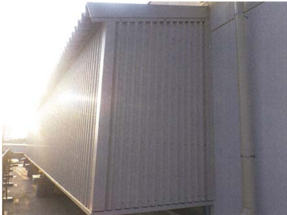
写真 2.1.5-3 外気取入フード 更新後（東側）
