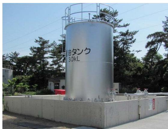
写真 2.1.19-3 緊急時用重油備蓄タンク
