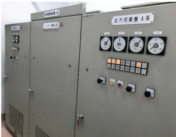
写真 2.10.3-1 無停電電源装置更新前
