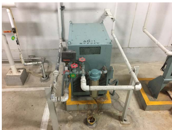
写真 2.1.9-1 更新前の除湿機
